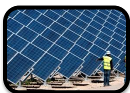
Instalações em Solo
